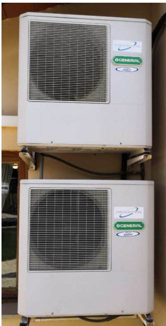
Imatge 13. Equips climatització.
