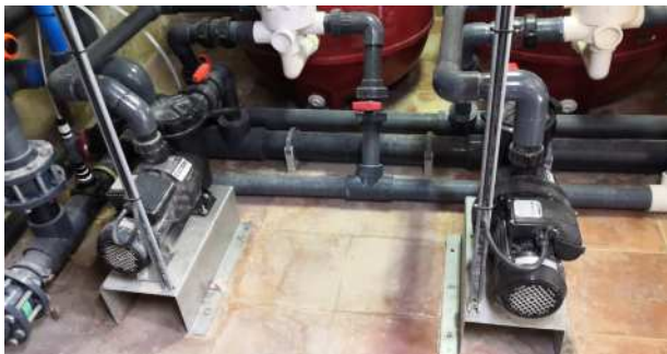
Imatge 25. Bombes depuració.
