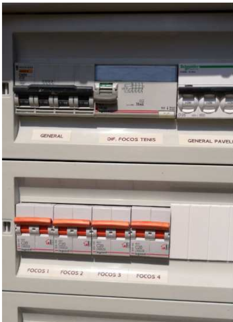
Imatge 10. Quadre il·luminació.
