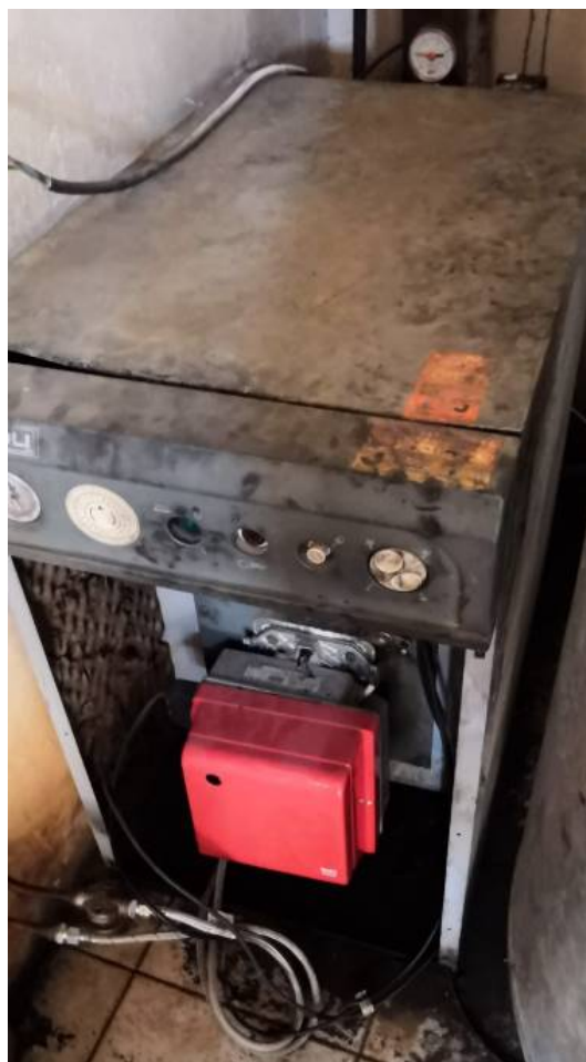
Imatge 9. Caldera gasoil.
