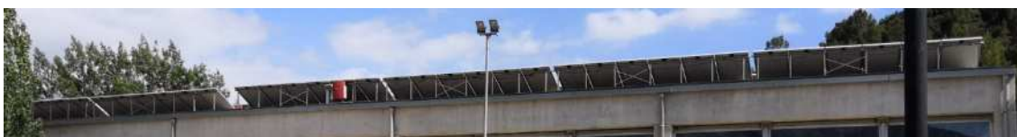
Imatge 28. Instal·lació Fotovoltaica venda a xarxa.
