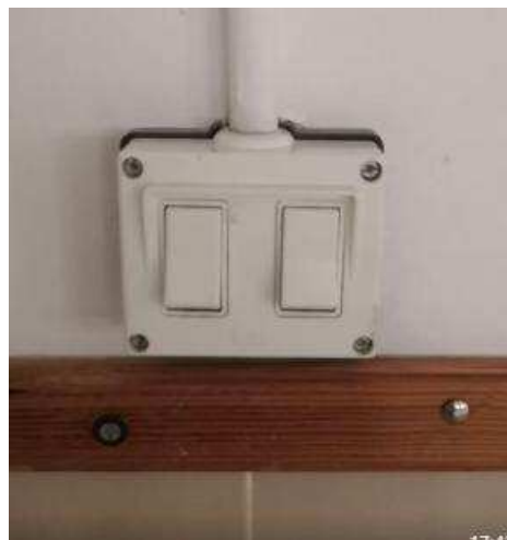
Imatge 9. Interruptors sectoritzats.
