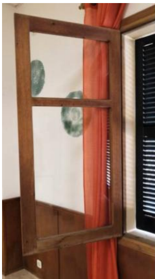
Imatge 23. Finestra doble amb vidre simple i lamel·les fixes horitzontals.
