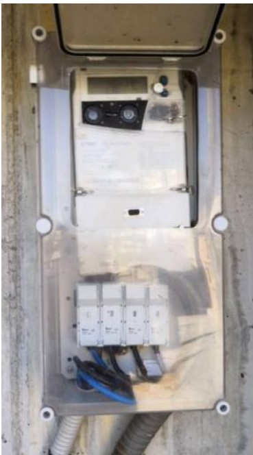
Imatge 4. Comptador elèctric.
