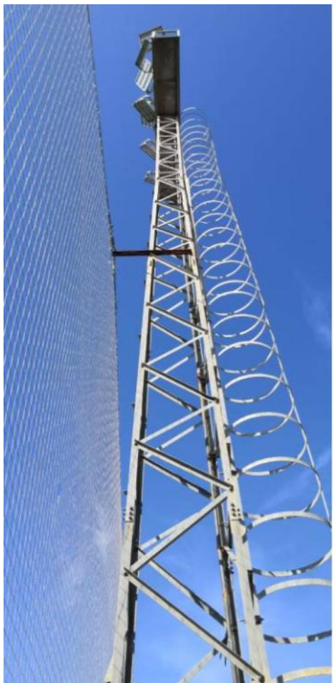
Imatge 6. Torre il·luminació.
