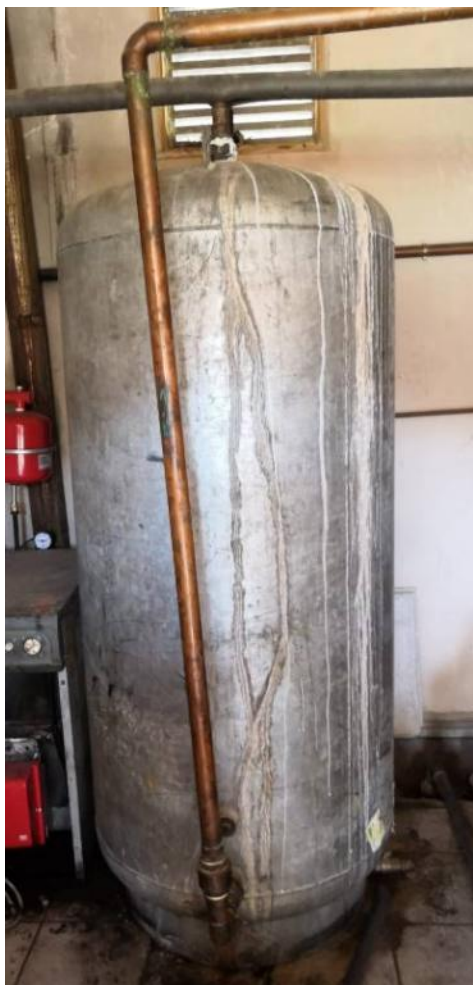
Imatge 8. Dipòsit ACS.
