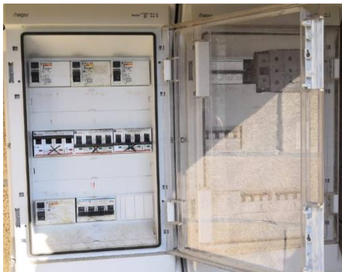
Imatge 5. Quadre elèctric.
