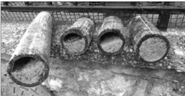
Estat de les canonades abans de fer la gran reforma de totes les conduccions de l'aigua del poble
